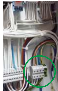
Elmatningen 3 x 400V 10 A är färdigkopplad på plint i styrcentralen.
